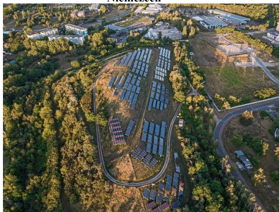
Rysunek 7 Instalacje fotowoltaiczne na dawnym składowisku odpadów we Frankfurcie nad Odrą w Niemczech
