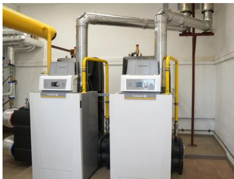
Zdjęcie 17. Kotłownia szkoły podstawowej Nr 5 w Strzelinie
