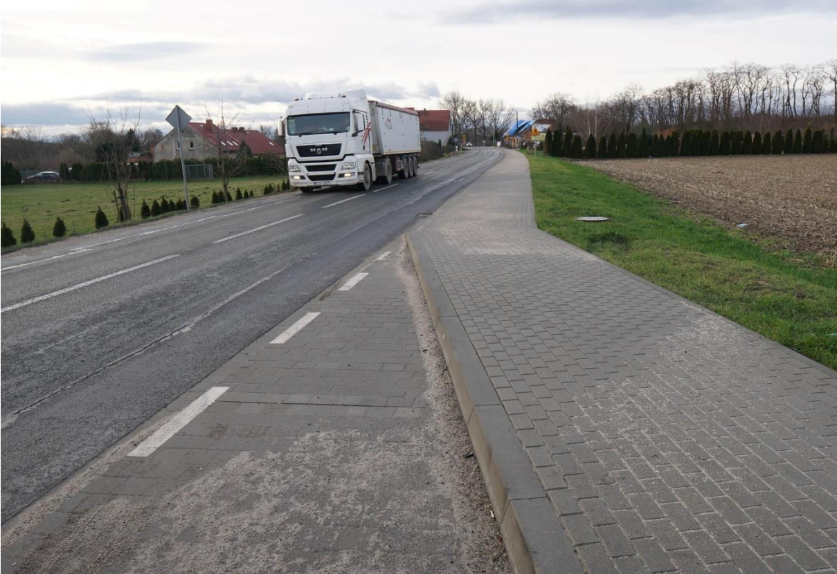
Zdjęcie 13. Budowa zatok autobusowych w m. Szczodrowice. Bariery ochronne na zdjęciu powyżej.
