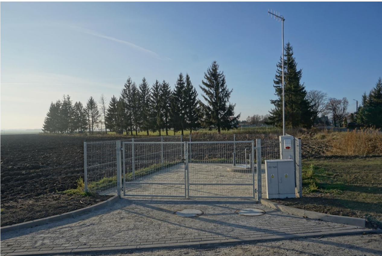
Zdjęcie 10. Pompownia ścieków w m. Karszów.
