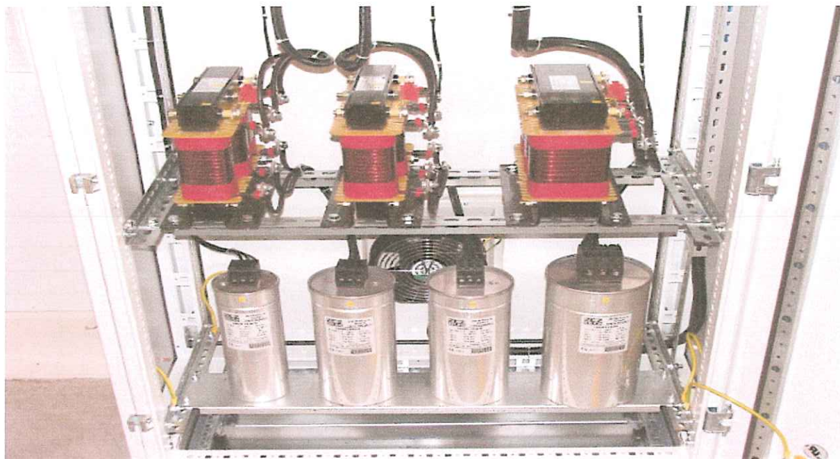
baterie kompensacyjne mocy biernej zainstalowane na obiektach ZWiK Strzelin
